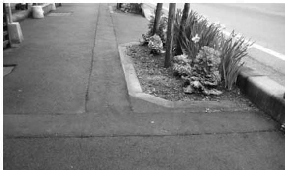
駅前歩道 木製タイルを取って応急措置されました
