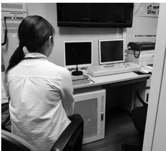
▲役場内の放送設備
