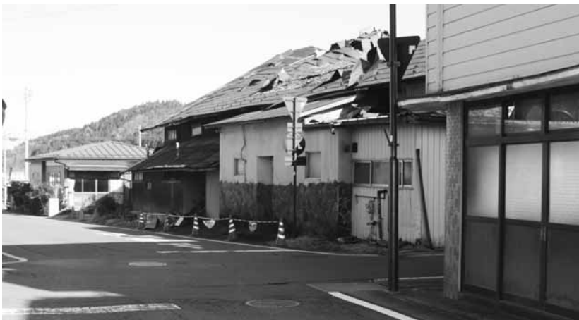
危険な状況にある旧浅川座
