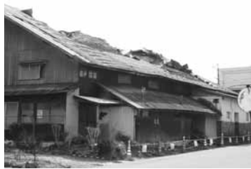
トタンが飛んで危険な空家
