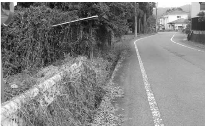
雑草も入り込んでいる側溝
