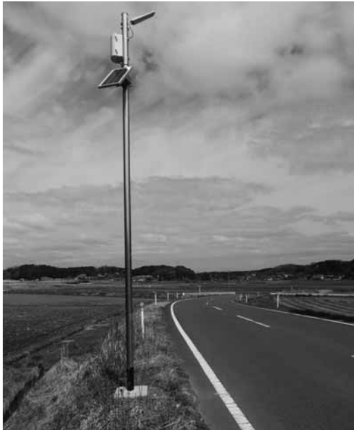
設置されたソーラー式街路灯
