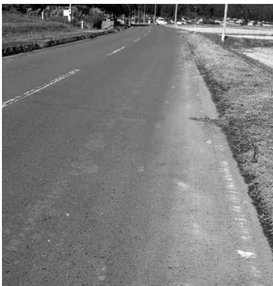
白線が薄くなった町道
