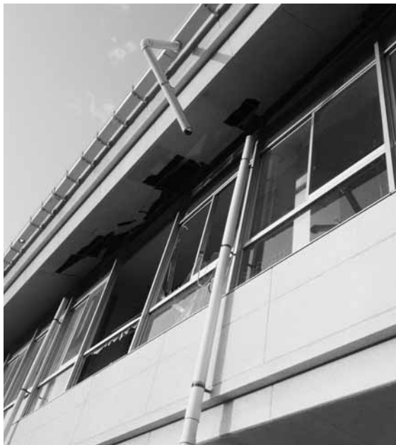
雨どいが壊れ軒天が落ちる被害を受けた
