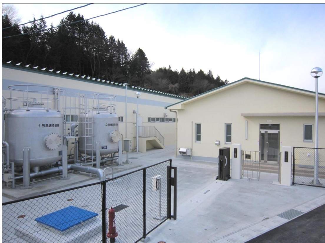
太田輪浄水場
