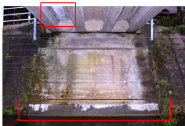
入ノ作橋: プレテンI桁橋 上・下部工の断面修復等を実施 診断区分: 補修前[II]→後[I]
