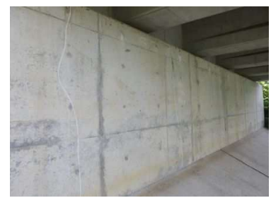
橋台のひびわれ(鉛直)
