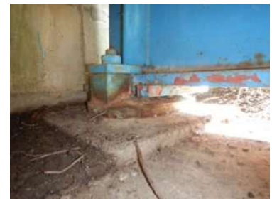
桁端部、支承の腐食
