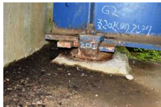
桁端部、支承の腐食
