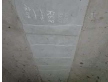
床版のひびわれ(橋軸直交)
