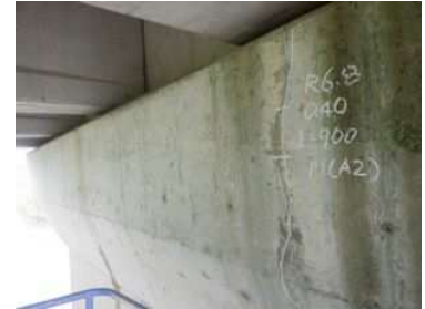
橋脚のひびわれ(鉛直)
