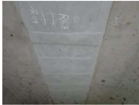
床版ひびわれ
