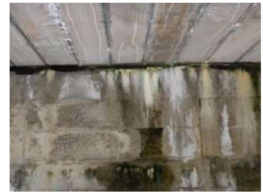
下部工の遊離石灰
