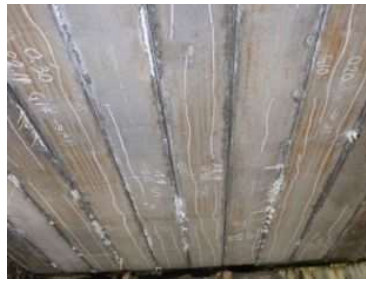
プレテン桁のひびわれ(橋軸方向)、遊離石灰
