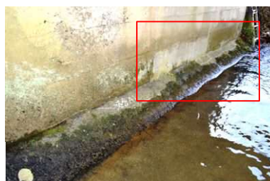
東今田橋: RC床版橋 下部工の断面修復等を実施 診断区分: 補修前[III]→後[II]
