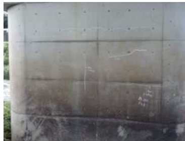
橋脚のひびわれ(二方向)
