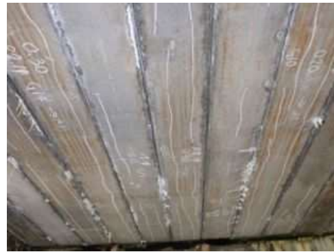
プレテン桁のひびわれ、間詰部の遊離石灰
