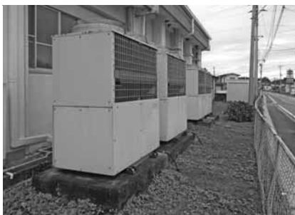
老朽化したエアコン
