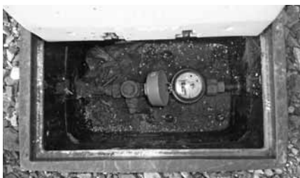
水道使用量メーター
