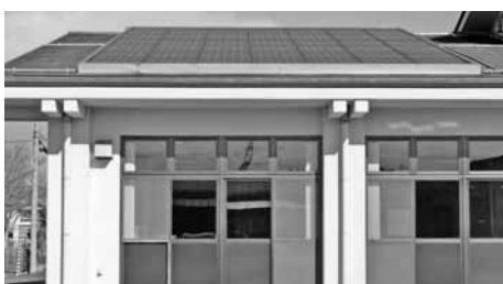
保健センター ソーラーシステム
