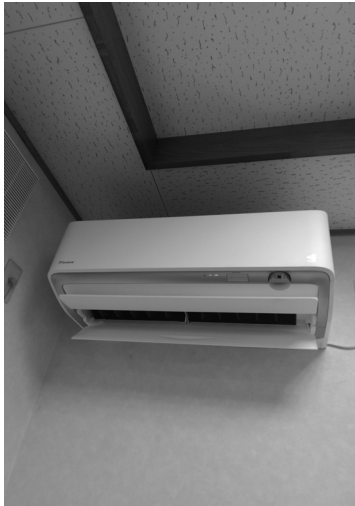
町の補助で中里コミュニティセンターに設置されたエアコン
