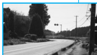
・歩道に沈んでいる箇所があり、カーブで見通しが悪い箇所もある。
