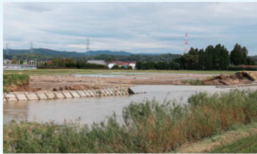
崩壊した護岸(小貫)
