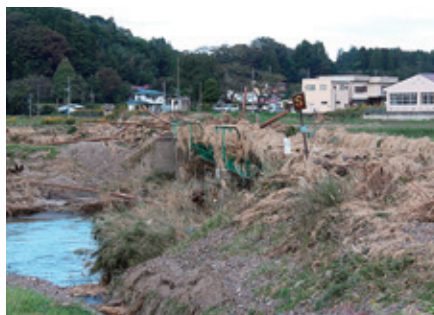
稲わらや流木が堆積した水郡線(里白石)
