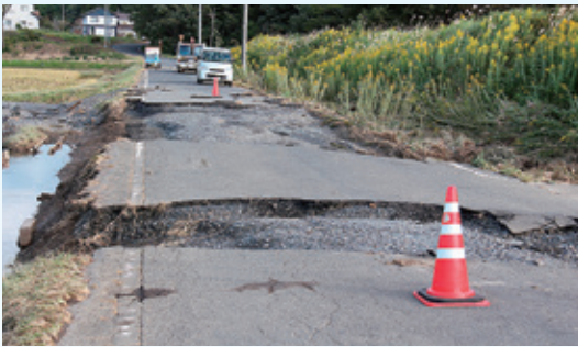
崩壊した道路(太田輪)
