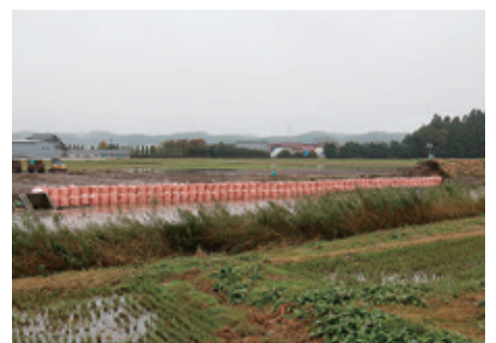
崩壊か所を応急措置した河川
