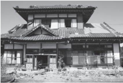
民家の被害状況
